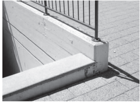
Abb. 9 Überhöhter Rand um Treppenabgang
